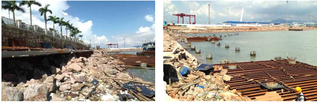
图5 “妮妲”台风风暴潮造成深圳湾滨海休闲带在建项目受损
