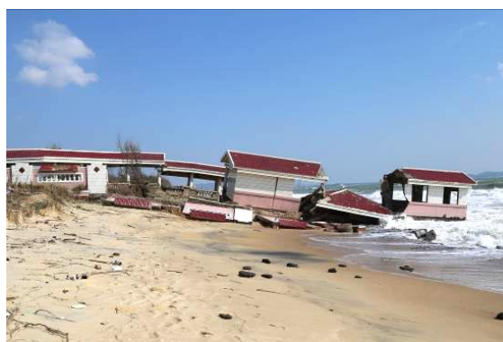
图 15 汕头龙虎湾海滩侵蚀情况
